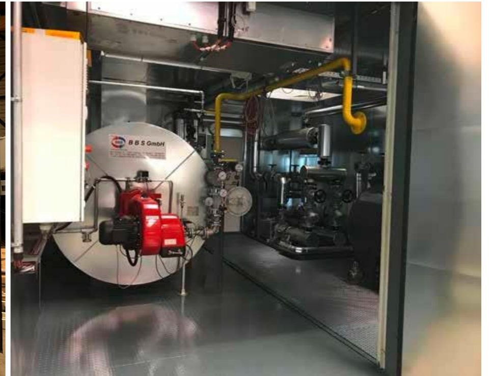
BBS-Containeranlage mit einem Thermalölkessel 1.200 kW. (Quelle: BBS)
